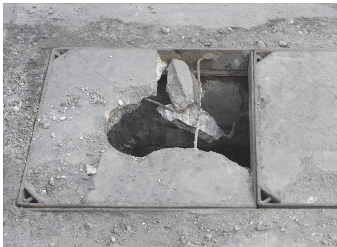
Rys. 3. Pokrywa studni kablowej rozbita przez złodziei w Warszawie w 2013 r.
