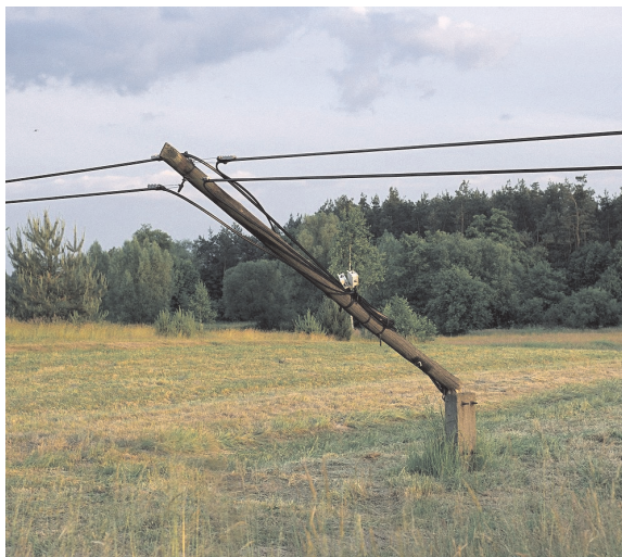
Rys. 2. Złamany drewniany słup w sieci dostępowej
