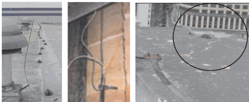
Rys. 3. Przykłady skutków bylejakości w doborze i instalowaniu elementów LPS
