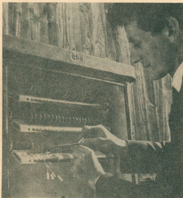
Rys. 1. Sprawdzanie połączeń w nowej doświadczalnej szafce kablowej. Każda półka w szafce może pomieścić 100 par kabli rozdzielczych i do 100 par kabla magistralnego
