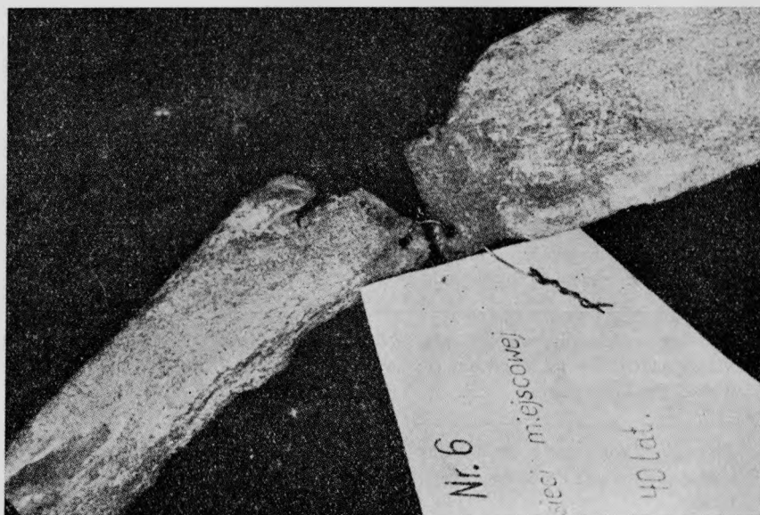
Rys. 3. Powłoka ołowiana kabla TKM 25×2×0,6 ułożonego w kanalizacji (tabl. 4)
